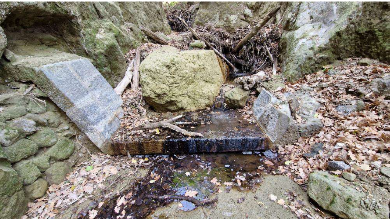
F_ 16_F. Briglia danneggiata risalente allo stesso periodo indicato nella precedente foto in corrispondenza del restringimento dell'alveo con notevoli quantità di materiale depositato.
