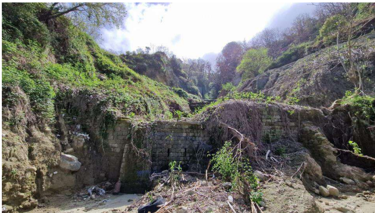
S_ 16_F. Dettaglio briglia in muratura danneggiata a seguito dell'evento dall'impatto di grossi massi trasportati dal flusso di acqua e fango proveniente da monte. Pareti acclivi sempre in fase di scivolamento con presenza di vegetazione
