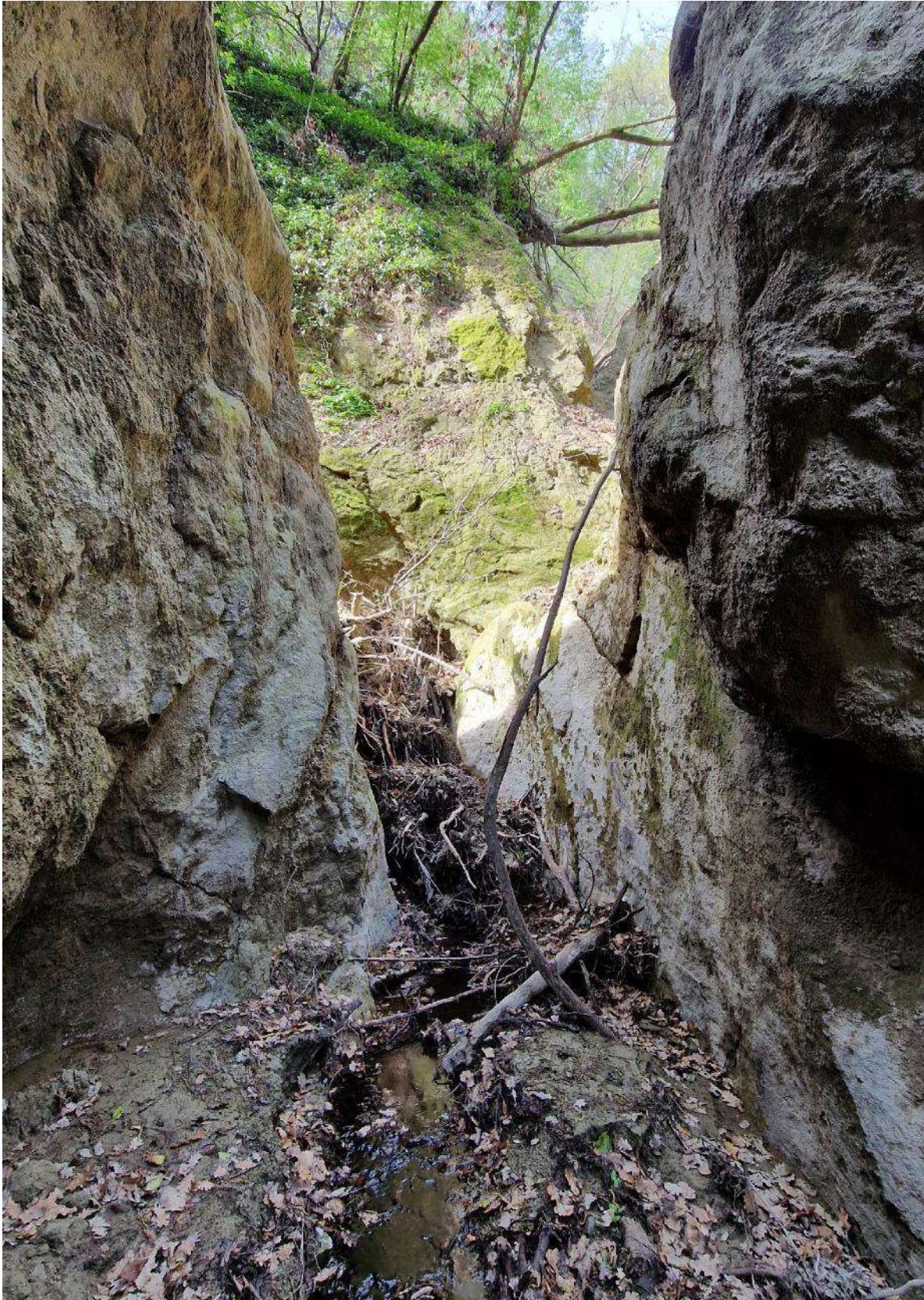
F_ 8_F. Confluenza tra Fasaniello e Campomanno con evidenti accumuli di terreno e vegetazione. La foto inquadra il tratto del Campomanno verso monte con una evidente incisione molto stretta in materiale tufaceo compatto.
