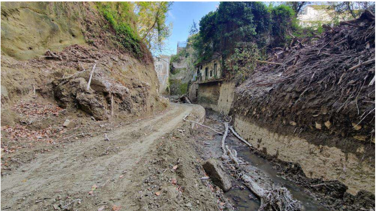
F_ 24_F. La foto rappresenta il tratto dell'alveo immediatamente a monte della sezione tombata. La sezione dell'alveo è ostruita parzialmente per alcuni metri di sviluppo longitudinale dalla presenza di terme risalenti. Si nota anche il parziale crollo della compagnatura dell'edificio che vi insiste sulla sponda destra
