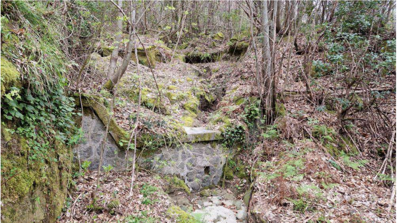
CU_6_F. Briglia realizzata intorno agli anni '40 in pietre squadrate e malta. Presenza massiccia di materiale di deposito precedente all'evento a monte e a valle
