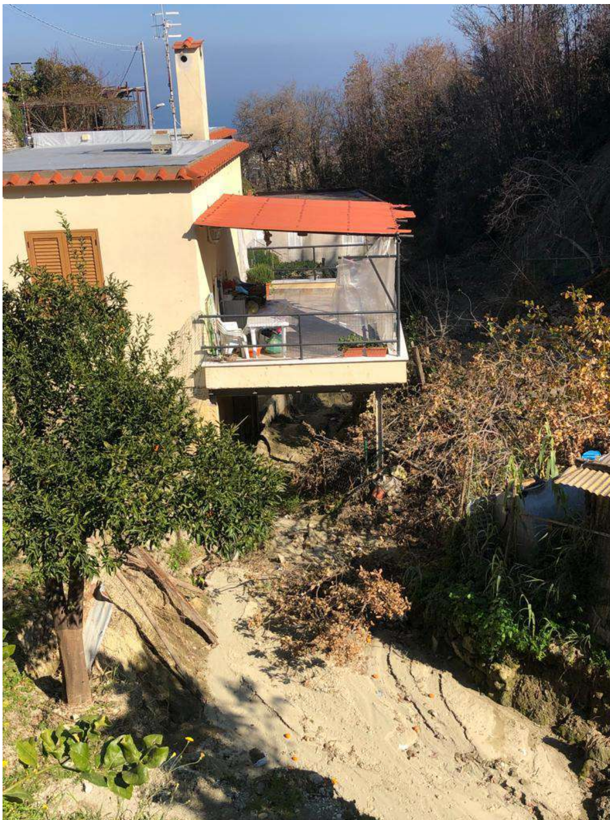
N_7_F. Presenza di un fabbricato per civile abitazione provvisto di un lungo balcone con pilastrini in acciaio che insiste sul letto dell'alveo. Si evince la presenza di accumulo di materiale vegetale sul fondo
