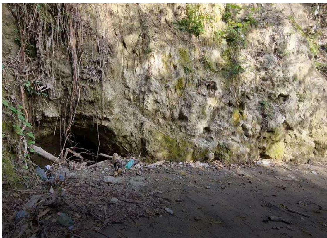
F_ 22_F. Canale di scolo delle acque parzialmente ostruito dalla presenza del fango e di detriti di origine naturale ed antropica.
