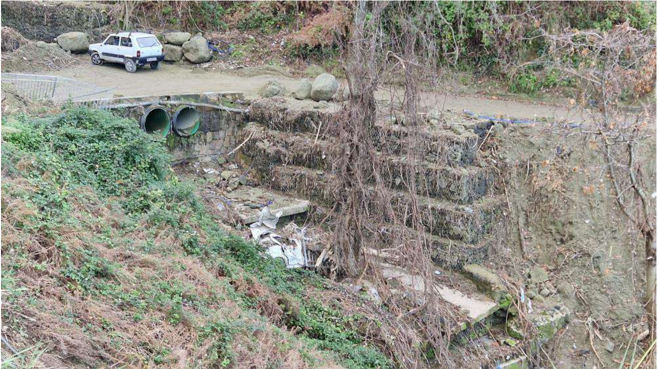
S_14_F. Tubazione di raccolta acque provenienti dalla vasca di accumulo posta a monte della strada Il Traversa Santa Barbara che attraversa l'alveo. È evidente che la sezione delle due condotte realizzate per consentire la realizzazione della strada risulti assolutamente inappropriato per la funzione idraulica che devono assolvere. Infatti, poco a valle la sezione idraulica dell'alveo presenta dimensioni decisamente importanti. La forza dell'evento ha trascinato un'auto proveniente, in base S_6_F
