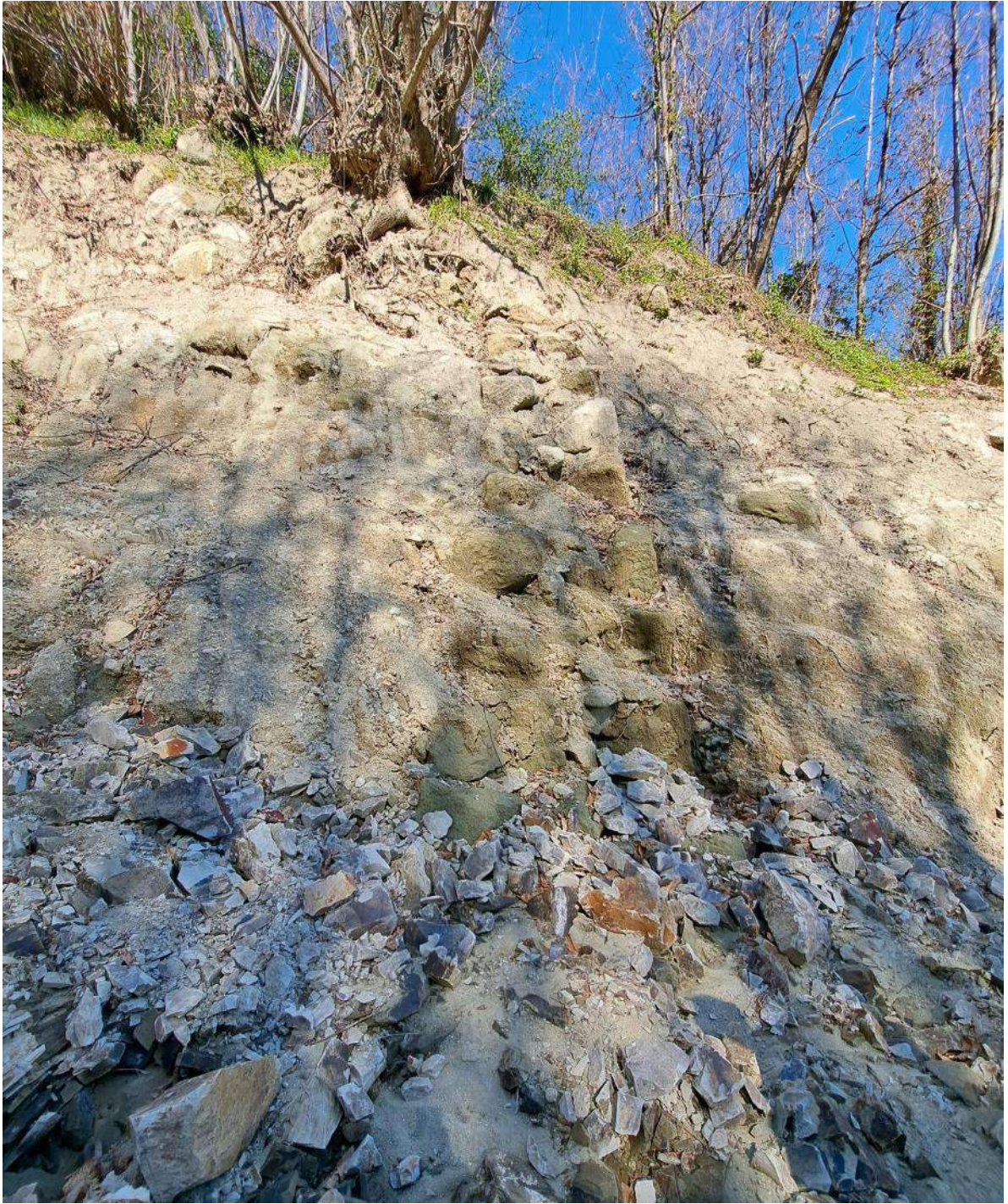
CE_3. Traccia di una briglia in muratura tranciata dall'evento meteorico del 2022
