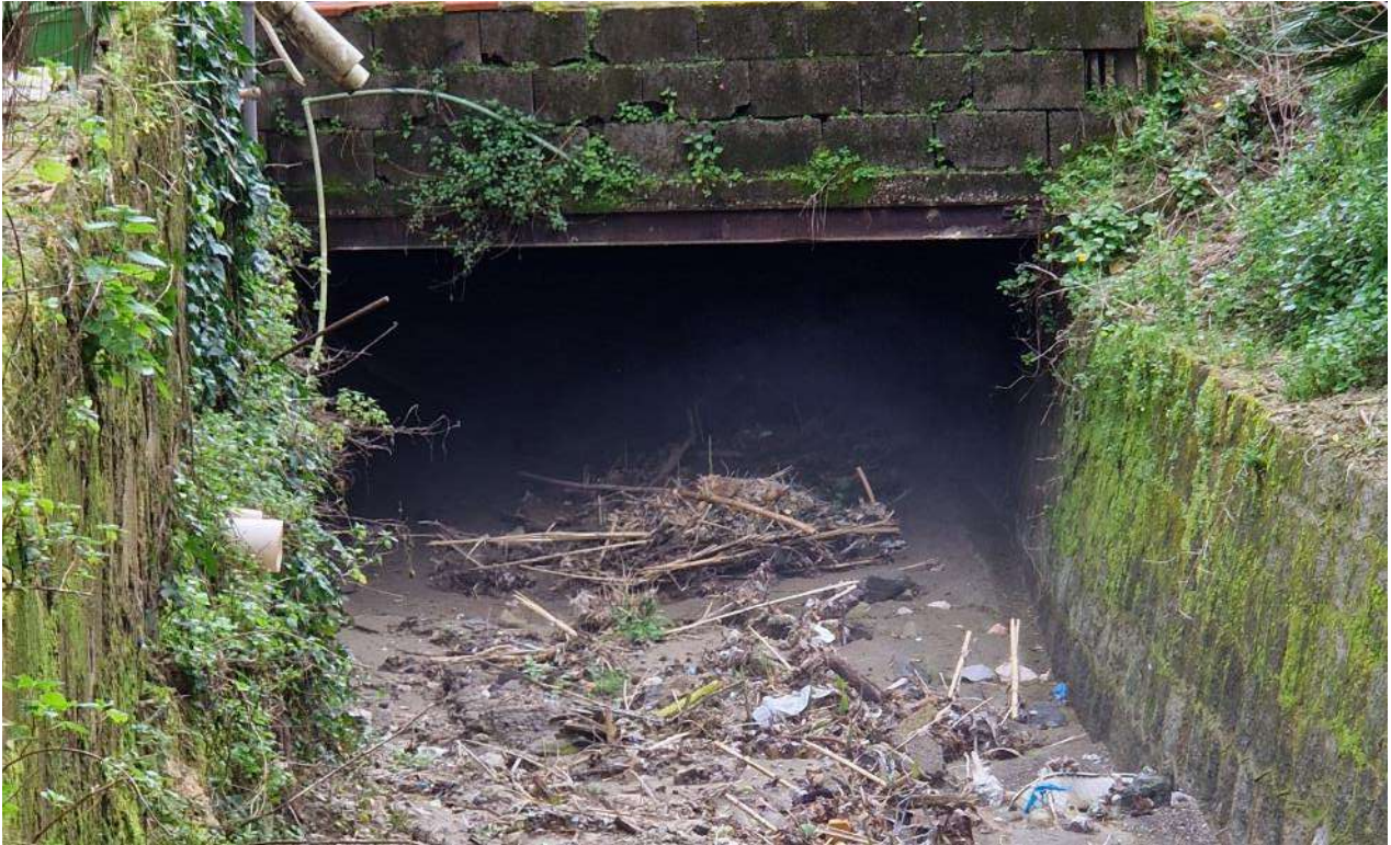
P_9_F. Imbocco dell'alveo a sezione aperta in corrispondenza della sezione di monte del tratto a sezione chiusa ovvero tombato; la sezione è chiusa tramite un solaio in putrelle e tavelloni utilizzato per l'accesso pedonale alle abitazioni. La luce libera è fortemente ridotta.
