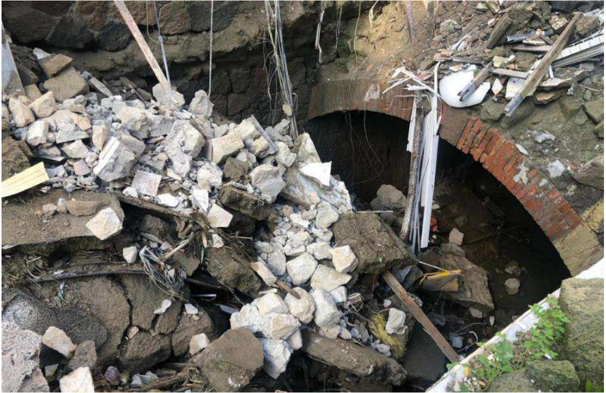
CU_ 19_F. tratto tombato in corrispondenza delle antiche terme la rita che in parte sono crollate
