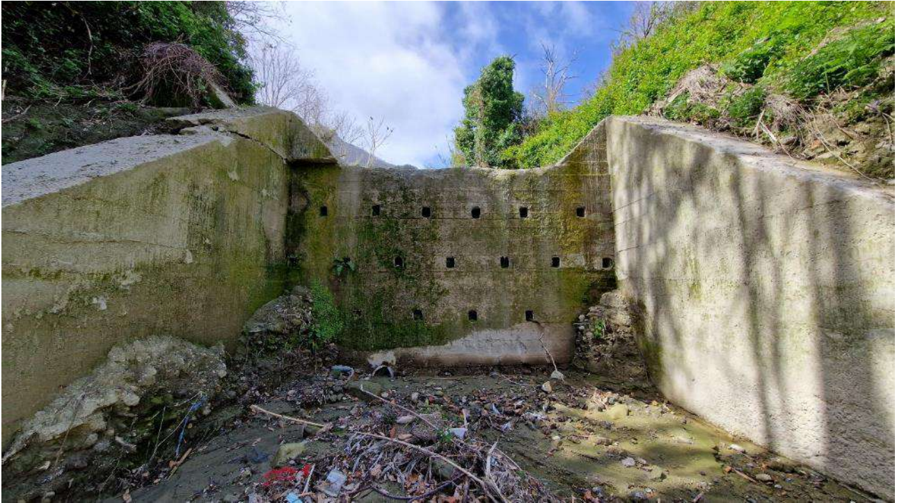
FO_9_F. Briglia in calcestruzzo armato di altezza circa 4 m realizzata a seguito dell'evento franoso del 2009. Si evidenzia un danno nella parte sommitale della sponda in destra idraulica. Deposito di materiale solidificato sul fondo
