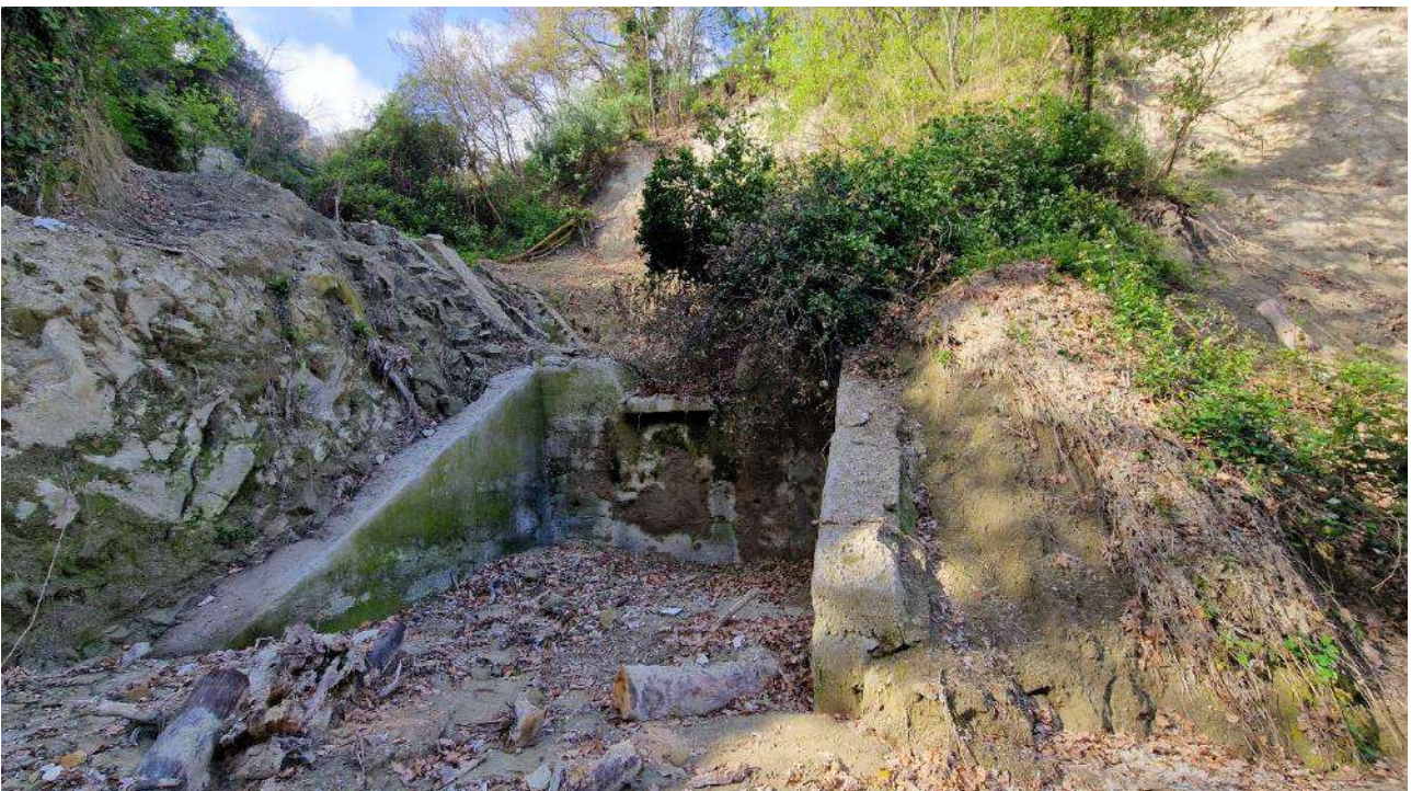
N_ 18_F. Terza briglia in muratura rivestita da uno strato di pozzolana altezza circa 2 m. La criticità principale è legata al deposito di detriti e vegetazione a monte della briglia ma anche ai lati dei muri di controvento.
