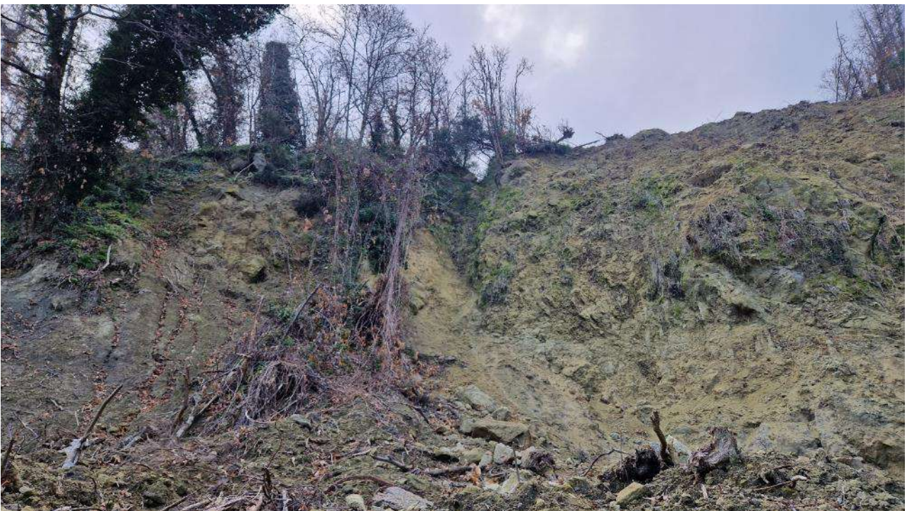
FO_5_F. Versanti acclivi dell'alveo caratterizzati da scorrimenti superficiali
