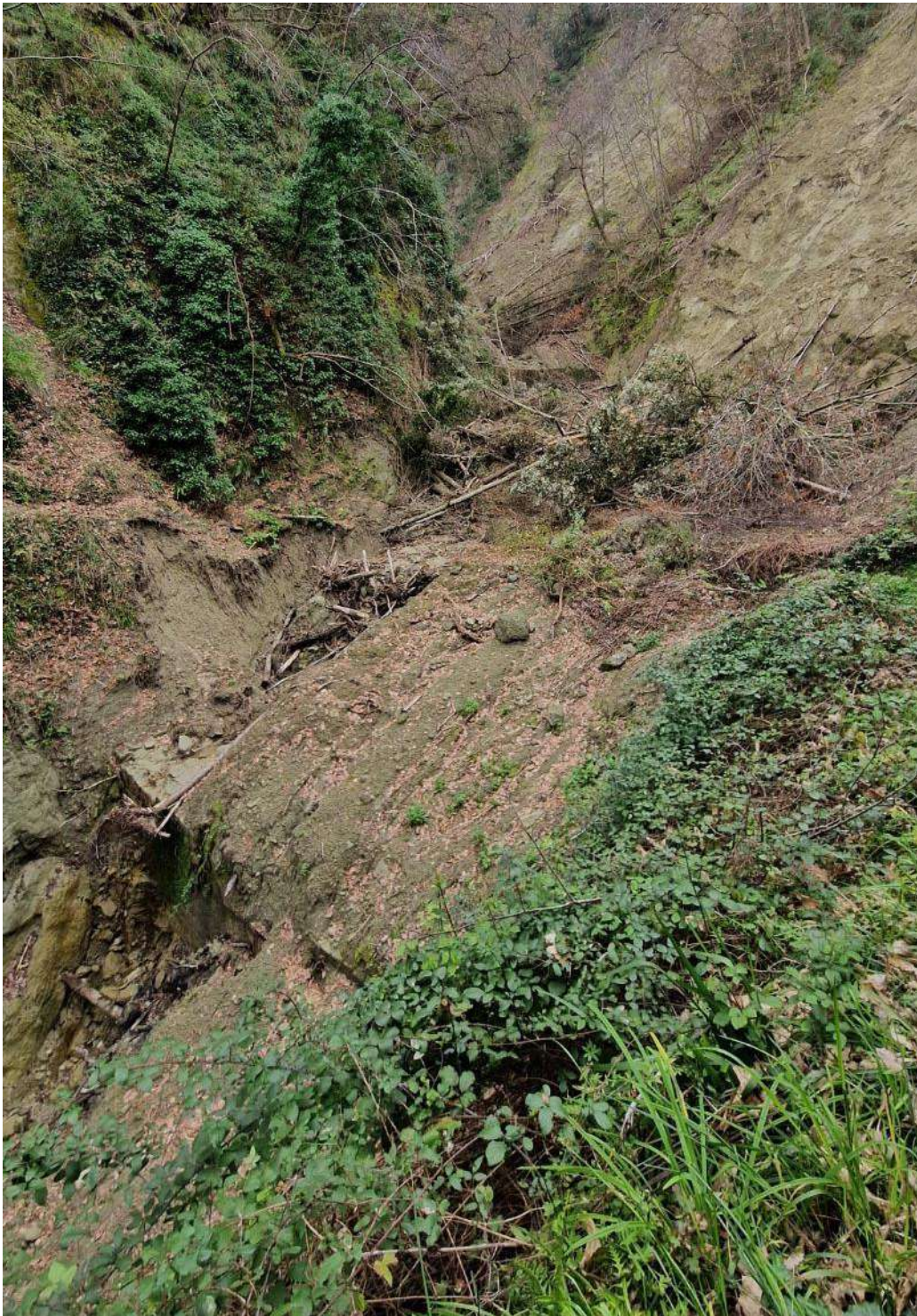
F_1_F. La foto illustra la forte azione erosiva generata dall'afflusso idraulico in corrispondenza di importanti spessori di depositi probabilmente risalenti o in parte confluiti durante l'evento meteorico del 26 Novembre. I depositi hanno duplice natura: trasporto e dislocazione dei pendii naturali testimonianze dall'assenza di vegetazione lungo le sponde. Secondo anche quanto riportato da testimonianze di abitanti del posto il tratto era completamente sommerso prima dell'evento tant'è che emergono le gavete delle briglie. Tramite il DTM viene stimato un valore medio di deposito al di sopra della gaveta di circa 5 m.
