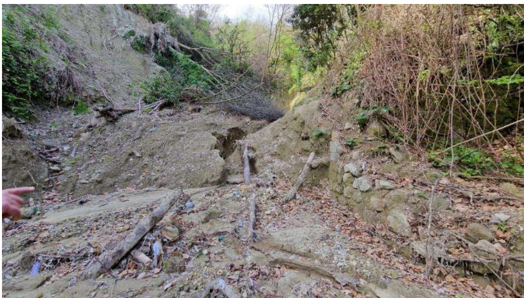
N_ 15_F. Fondo dell'alveo caratterizzato da depositi e fenomeni erosivi prodotti dall'evento meteorico del 26 novembre. Sezione di alveo caratterizzata da sponde realizzate con muretti a secco parzialmente collassate. Si evidenziano distacchi di materiale e caduta di alberi dalla sponda in destra idraulica
