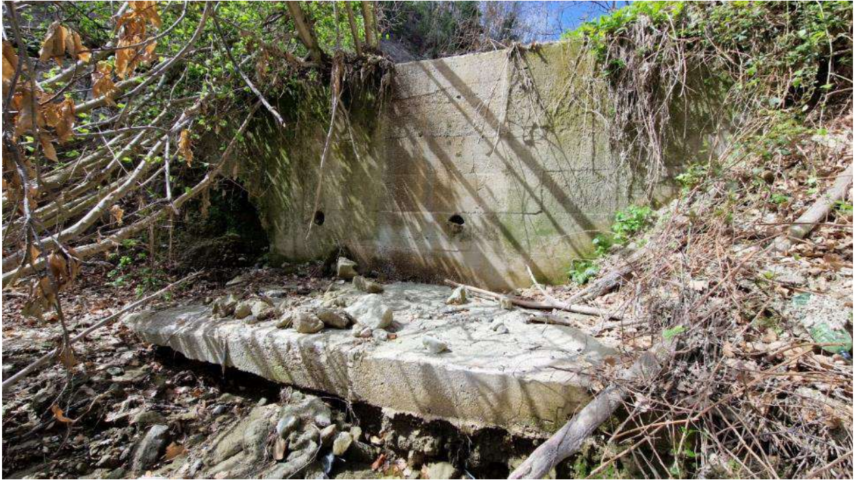
Ultima Briglia in Cemento armato di altezza circa 3 m realizzata post evento 2009 con fondazioni esposte ed erosione del letto di fondazione
