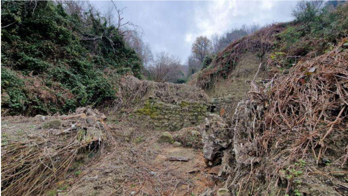
N_ 4_F. La foto rappresenta una sezione dell'alveo in cui una briglia costituita da blocchi lapidei non smussati, parzialmente crollata con consistenti depositi di materiale a monte e a valle. Presenza di folta vegetazione sulle sponde laterali
