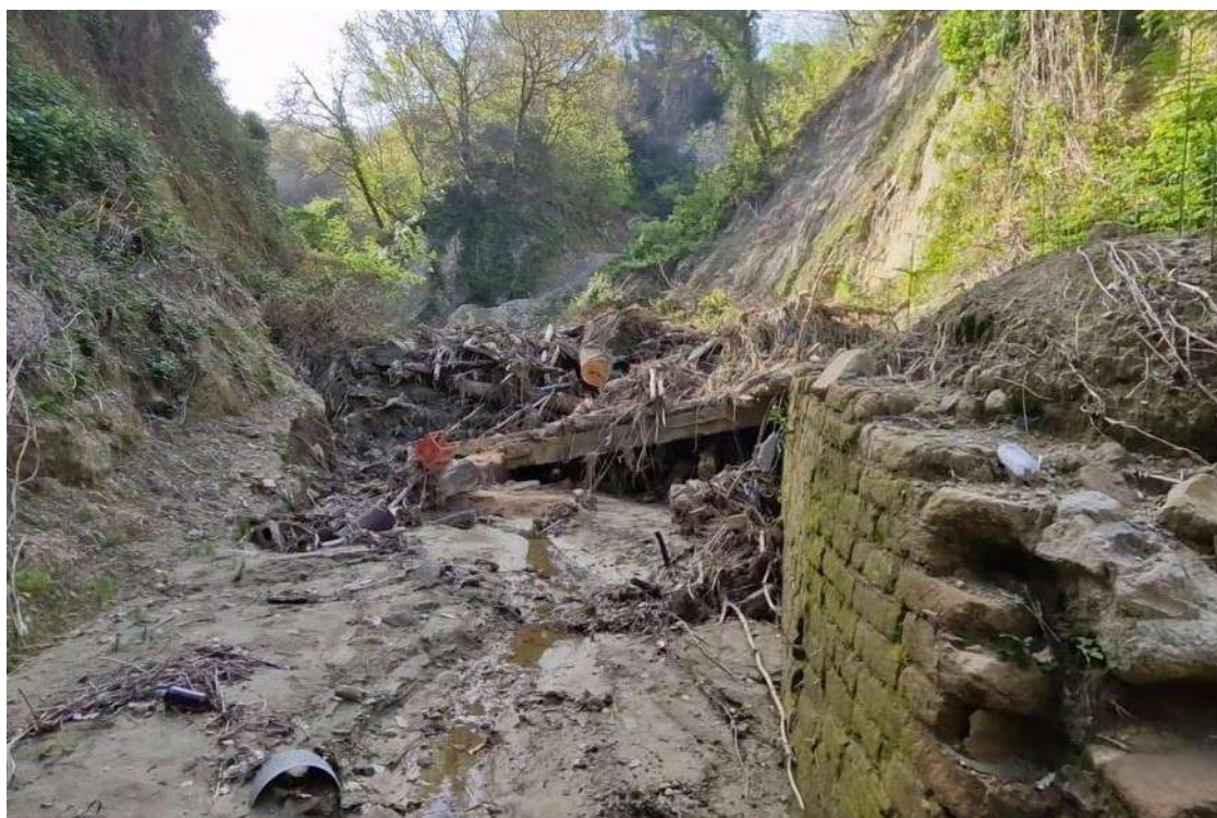
F_20_F. Ponte di attraversamento dell'alveo crollato con accumulo di materiale misto detritico e ligneo a monte.
