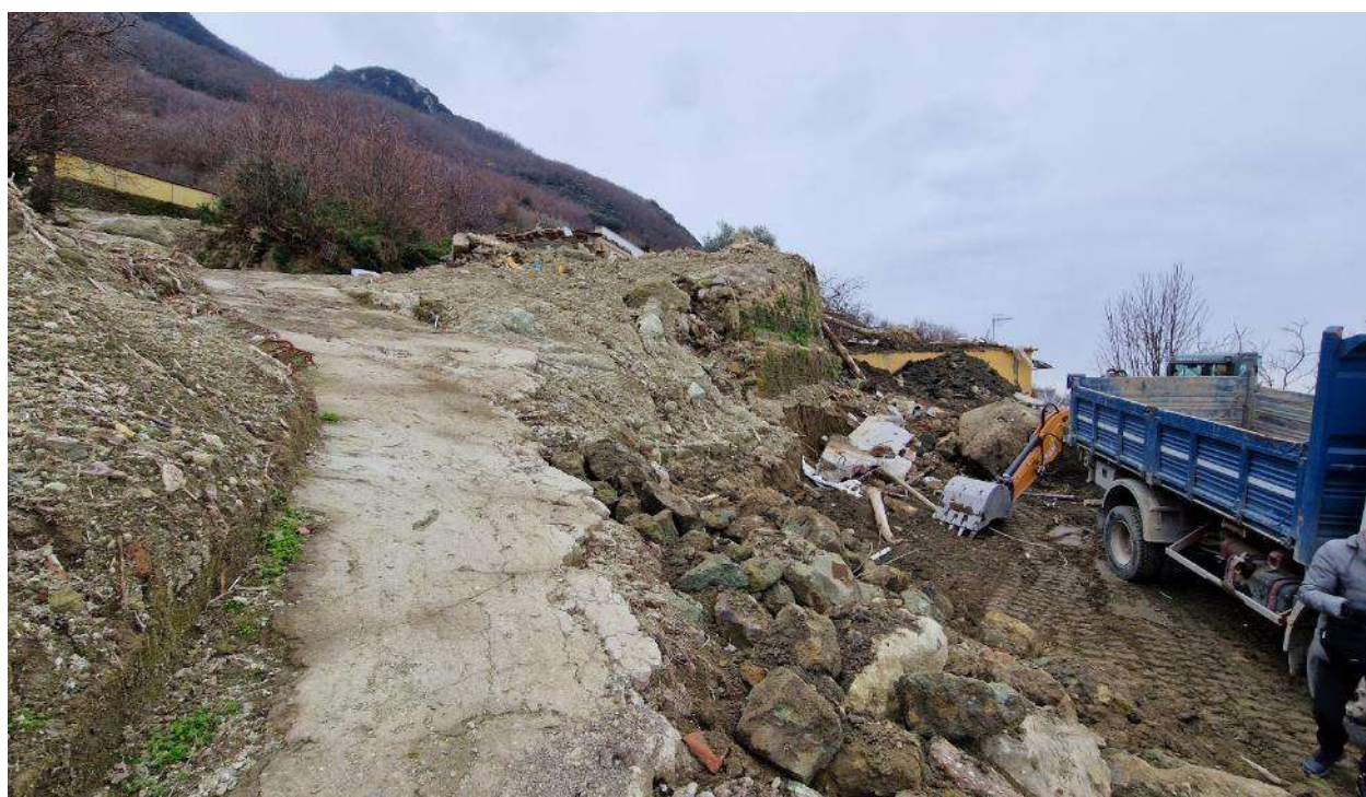
CE_ 11. Stradina cementata che intercetta l'alveo Celario. Parziale collasso dell'opera di sostegno in prossimità della strada
