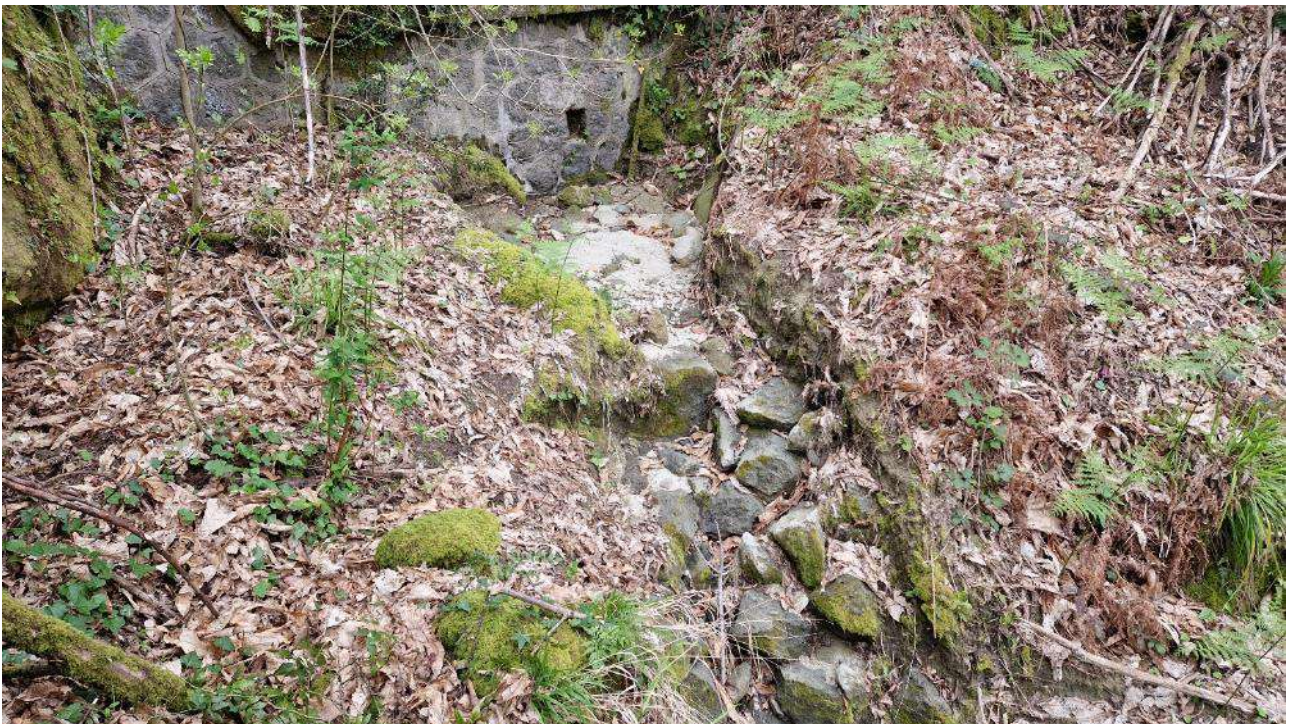
CU_7_F. Azione erosiva dell'evento meteorico del 2022 del materiale depositato sul fondo dell'alveo
