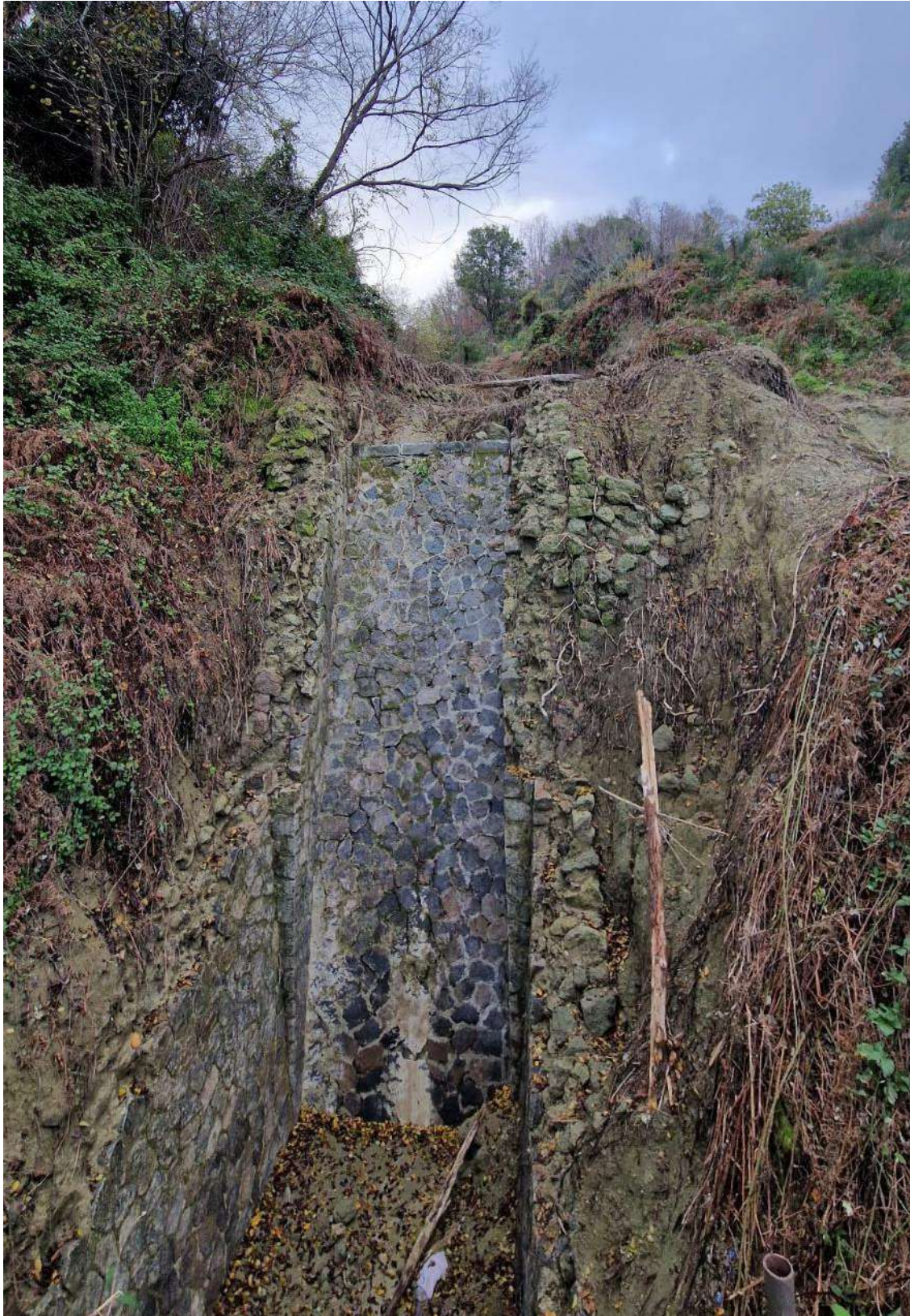
N_5_F. Salto di altezza di circa 6 metri risalente presumibilmente al periodo degli interventi realizzati negli anni '30 del secolo scorso. Si rileva l'alterazione superficiale della muratura dovuta all'acqua termale. Accumulo di fango e vegetazione sul fondo. Le sponde laterali sono parzialmente crollate
