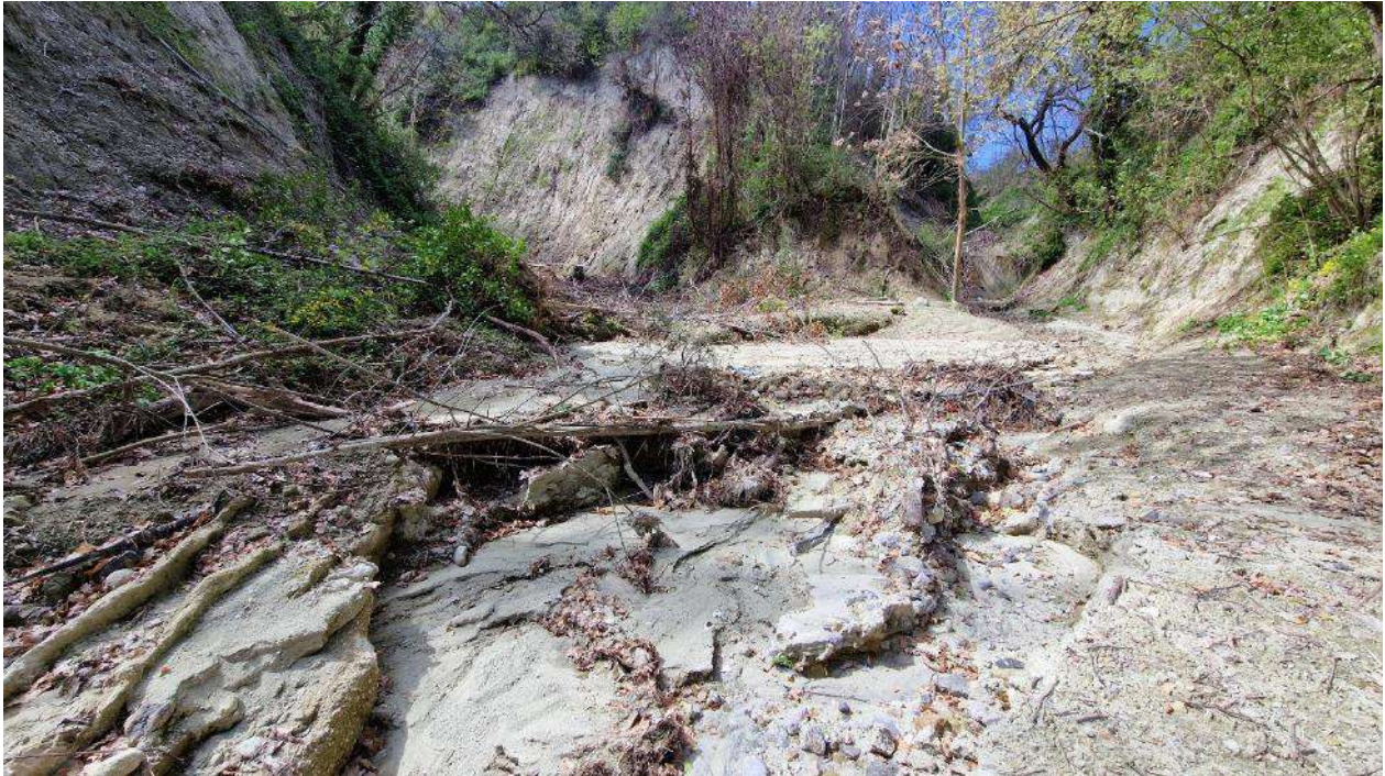
S_ 20_F. Zona di accumulo posta a valle delle sistema di briglie in corrispondenza della confluenza con l'alveo Fontana.
