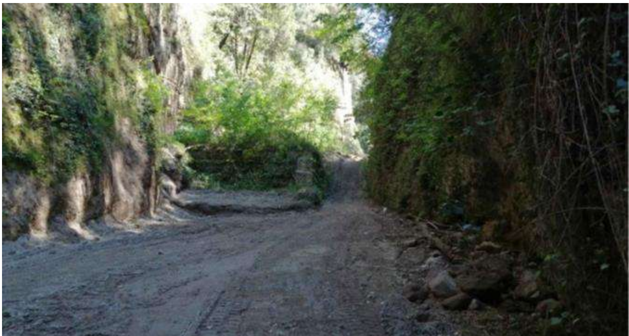
P_2_F. Vista da valle, prodotta in tempi anteriori al 26 novembre del 2022, di una vasca di accumulo di altezza pari a circa 3 m e sedime di circa 6x10 mq, realizzata in corrispondenza dell'alveo con gabbioni metallici. L'alveo in
