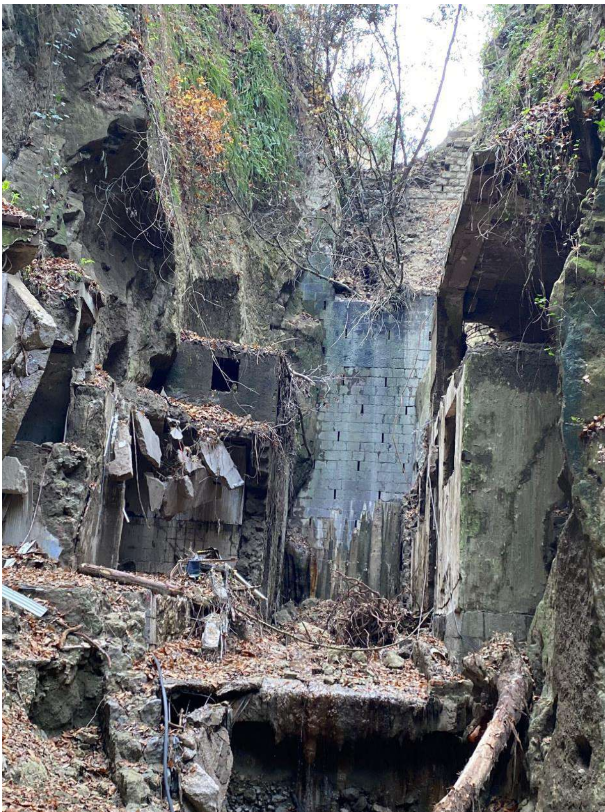
S_22_F. Grossa briglia di altezza di circa 20 m posta poco prima della zona tombata nel tratto urbanizzato. Alla base è stato edificato un impianto termale denominato Terme Piro, in parte collassato ed in parte in incipiente stato di collasso tale da produrre ulteriori elementi all'interno dell'alveo.
