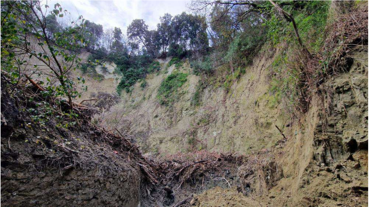
F_ 23_F. Materiale di accumulo di altezza pari a circa 5 m in corrispondenza dell'alveo e pareti laterali fortemente acclivi
