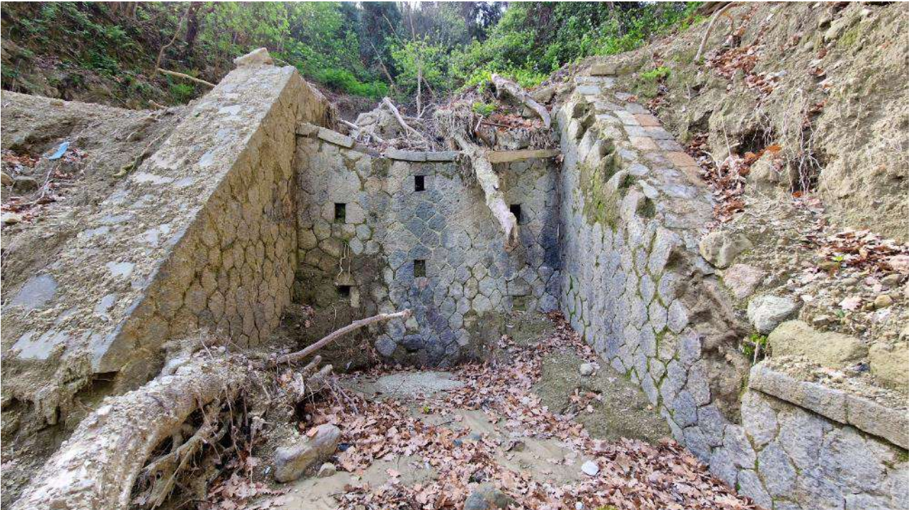
N_ 17_F. Seconda briglia in pietre squadrate di altezza pari a circa 4 m. Parziale danneggiamento delle sponde in sinistra e in destra idraulica. Accumulo di vegetazione e detriti nella sezione di monte e di valle.
