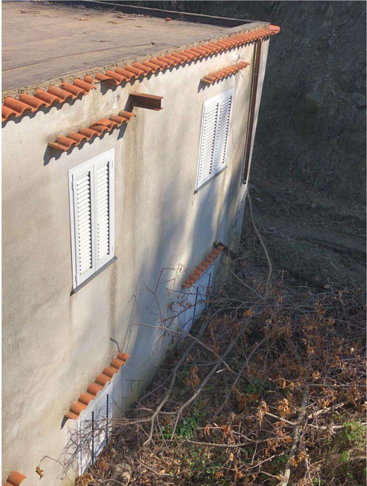
N_ 8_F. Accumulo di fango e tronchi d'albero a ridosso di un fabbricato per civile abitazione. Parziale ostruzione delle finestre del piano primo
