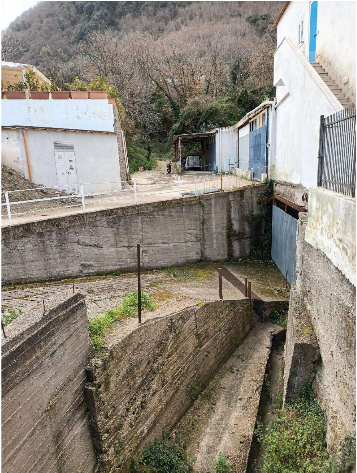
MO_4_F. Immissione tratto tombato in corrispondenza del deposito realizzato in corrispondenza dell'alveo
