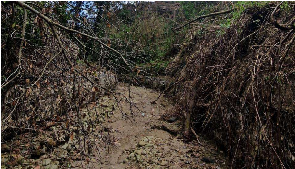
P_4_F. Gabbionate metalliche realizzate nell'intervento post frana 2009 per riprofilare l'alveo in corrispondenza delle sponde; è evidente la massiccia presenza di materiale di accumulo e vegetazione proveniente dalle pareti laterali o dal trasporto in condizioni di forte afflusso meteorico. Le gabbionate hanno in parte resistito alla forte azione di
