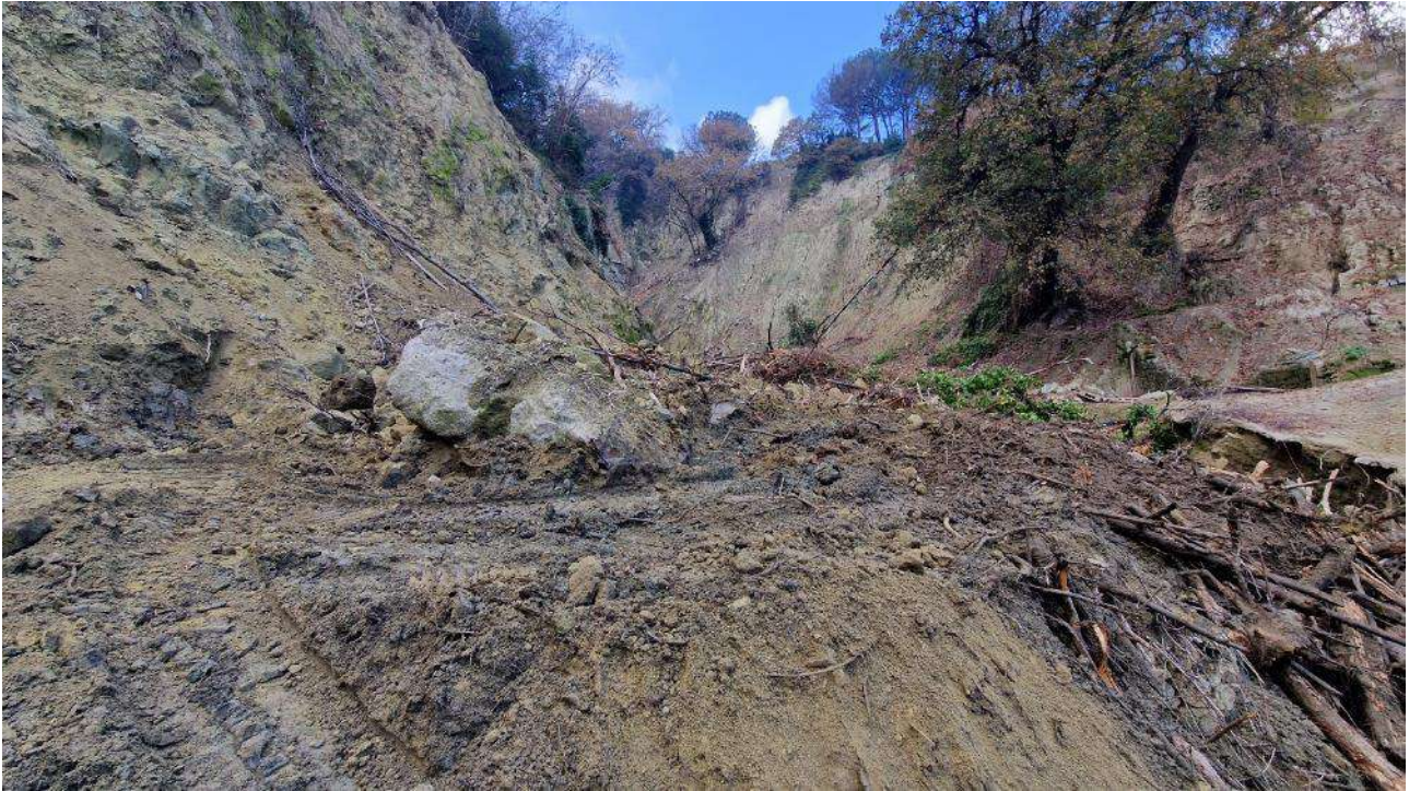
FO_2_F. Alveo a valle del salto caratterizzato da pareti acclivi e deposito sul fondo. Pareti con forti scivolamenti della coltre superficiale.
