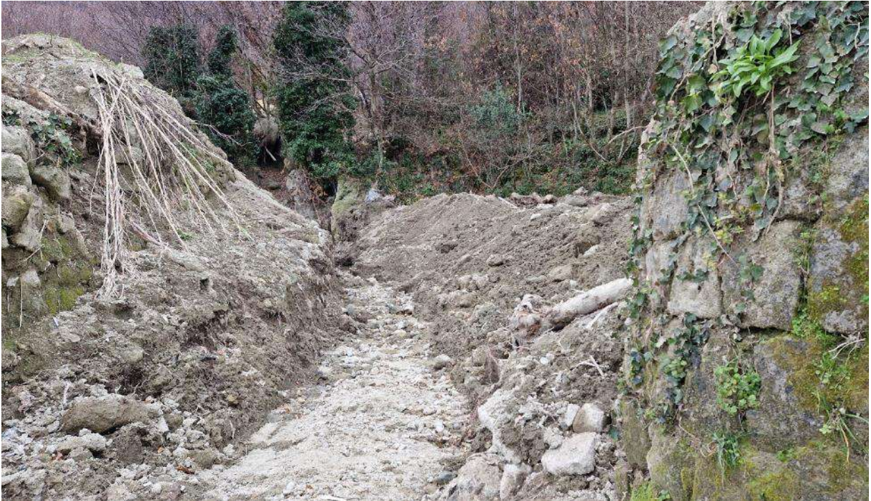
CE_ 12. Fondo cementato dell'alveo Celario. Presenza massiccia di fango e detriti lungo le sponde laterali
