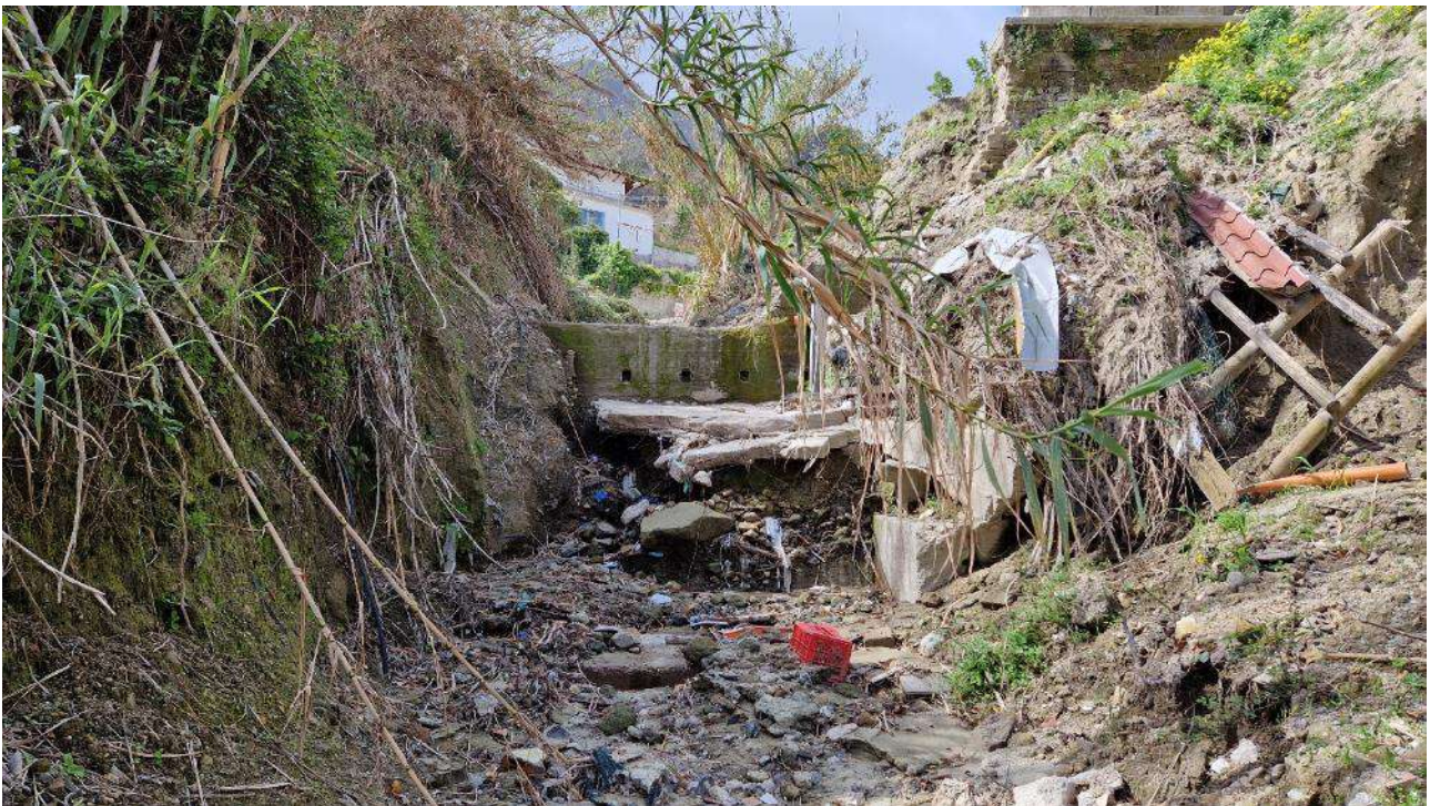
FO_9_F. Briglia in calcestruzzo armato di altezza pari a circa 1,80 m, realizzata a seguito dell'evento del 2009 con fondazioni esposte e collassate. Presenza massiccia di vegetazione e fango lungo i versanti
