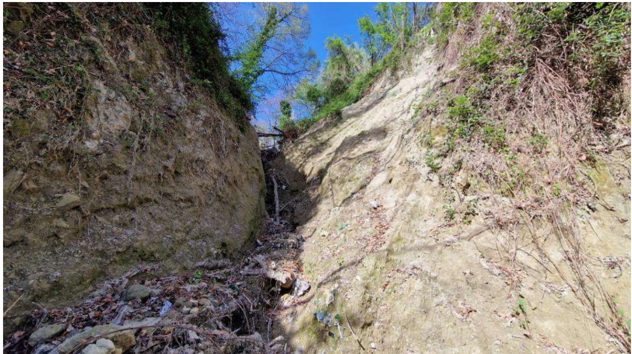
N_12_F. Tratto caratterizzato da una sezione molto stretta con forte acclività delle sponde laterali e deposito di materiale di varia natura sul fondo. Le criticità principali sono: alberi di dimensioni importanti pronti allo scodellamento, scorrimenti superficiali lungo le pareti in alveo, erosione del piede dei versanti, fondo dell'alveo completamente sommerso da materiali detritici.
