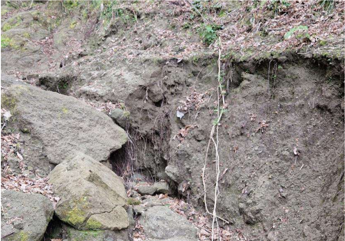
S_4_F. Materiale eroso fondo alveo a seguito dell'evento meteorico del 26 novembre altezza circa 0,80 m
