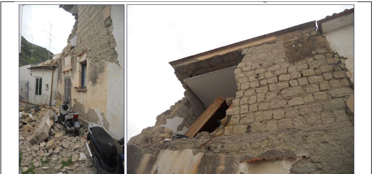
Fig.3– Danni riscontrati in edifici in muratura di blocchetti di tufo – Casamicciola Terme- Località La Rita
