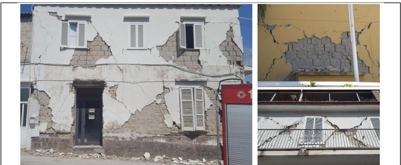
Fig.4– Danni riscontrati in edifici in muratura– Casamicciola Terme- Località Piazza Maio
