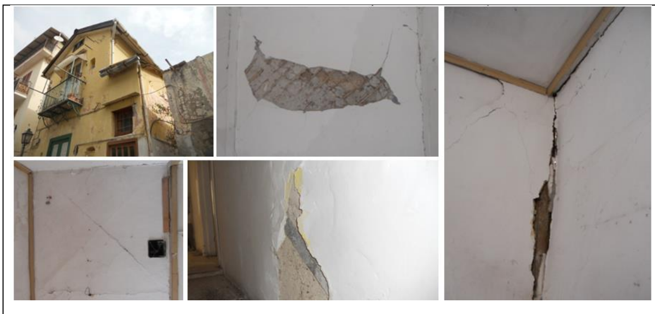
Fig.13– Danni riscontrati in edifici in muratura baraccata– Casamicciola Terme- Località San Severino
