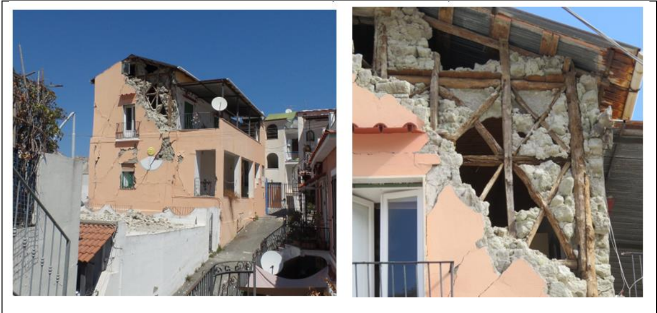
Fig.14– Danni riscontrati in edifici in muratura baraccata– Casamicciola Terme- Località Piazza Maio
