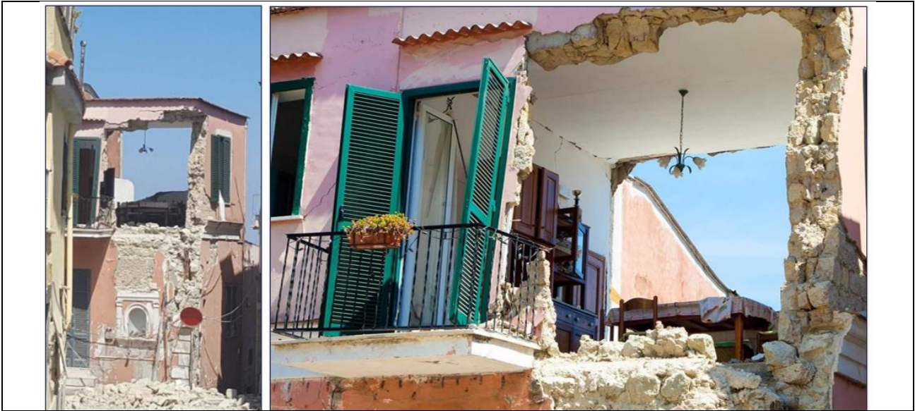
Fig.2 – Danni riscontrati in edifici in muratura di tufo – Casamicciola Terme- Località Piazza Maio
