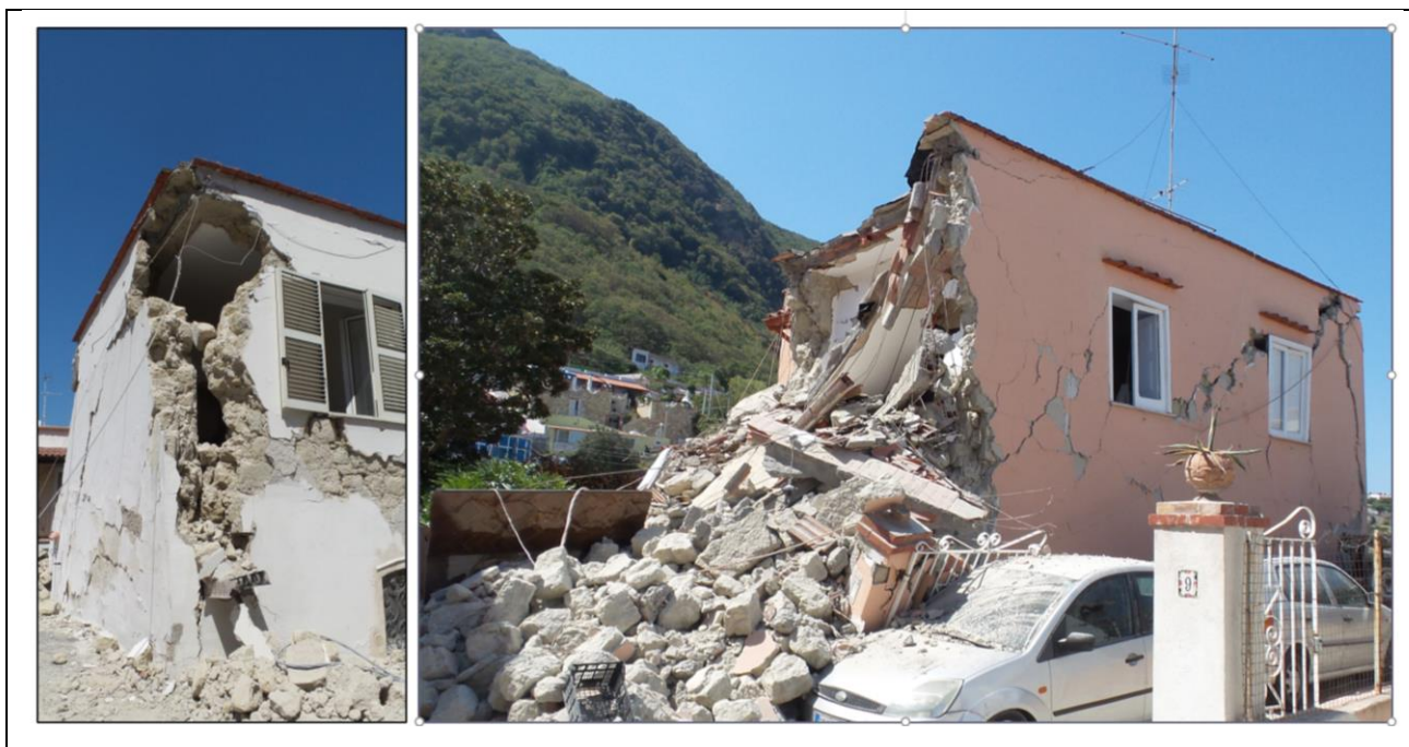
Fig.1 – Danni riscontrati in edifici in muratura di tufo – Casamicciola Terme- Località Piazza Maio
