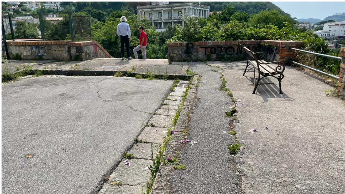
Figura 47: Lesioni presenti sulla strada, sul marciapiede e sul muretto antistante l'edificio scolastico Manzoni.
