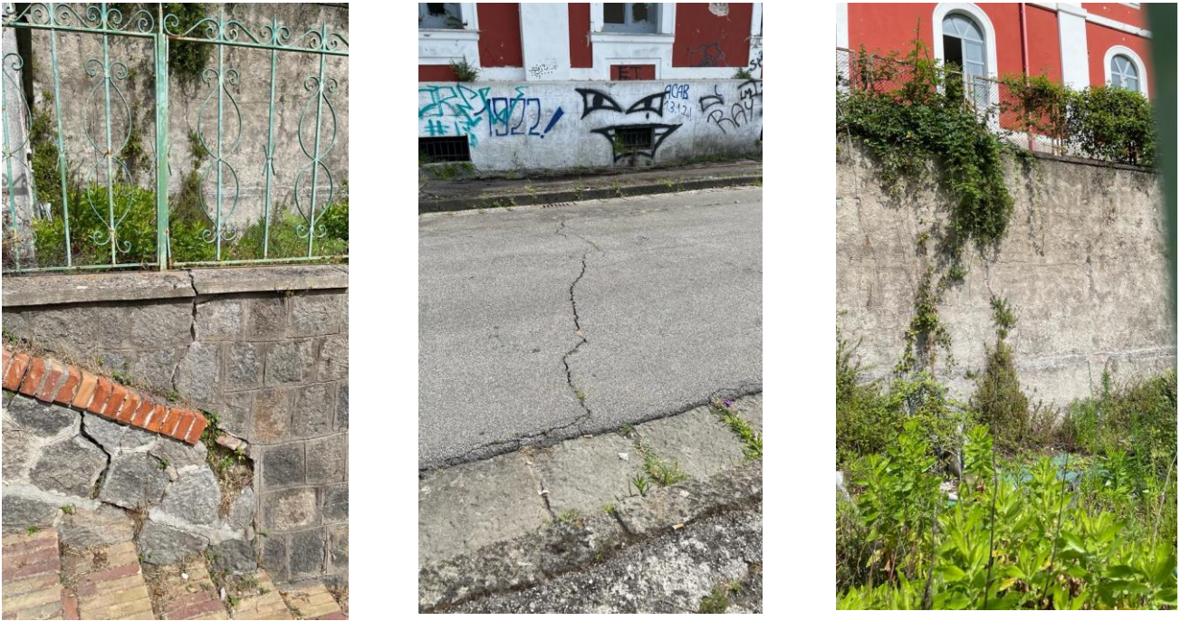
Figura 48: Lesioni presenti sulle scalette, lungo la strada e sui muri di contenimento (edificio scolastico Manzoni).
