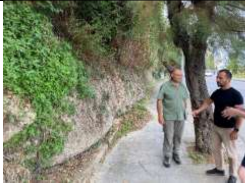
Reti in acciaio contro le frane. La struttura è al limite della sua capacità e deve essere ricostruita o eventualmente sostituita da un muro.
