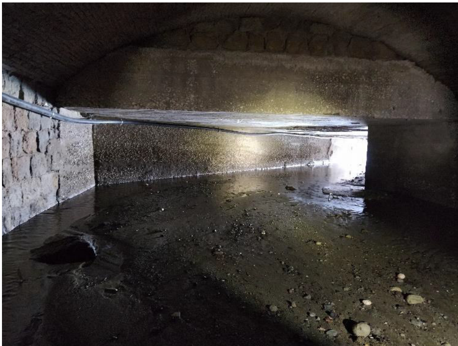
Figura 6. vista da monte verso valle dello scatolare di scarico, in prossimità dello sbocco a mare. Sezione
